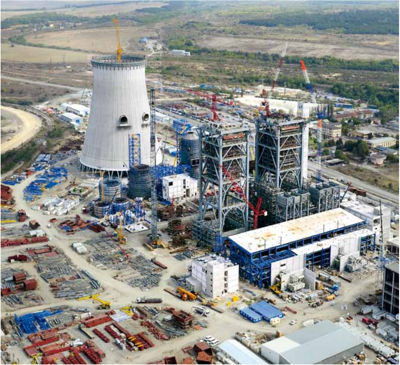
Maritza (Meriç) Termik Santrali, 2006-2008, Bulgaristan.
