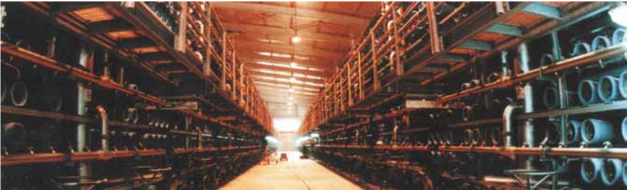
Cubail Deniz Suyu Arıtma Tesisi, 1992-2001, Suudi Arabistan.
